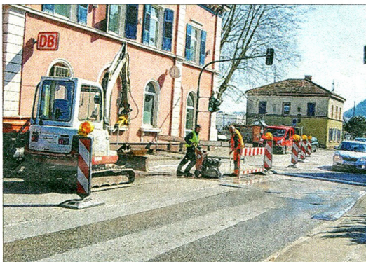
Arbeiten an der Ortsdurchfahrt gab es beispielsweise 2018 wegen eines Wasserrohrbruchs. Auch damals musste der Verkehr umgeleitet werden. Archivfoto: Manfred Pregel
